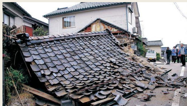
写真：地震で倒壊した家屋(珠洲市正院町正院) 北國新聞 2023年5月6日号より引用
