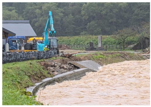
再び氾濫しそうな桧木内川で、えぐられた川岸に土のうを積む重機【9/2(火)撮影】
